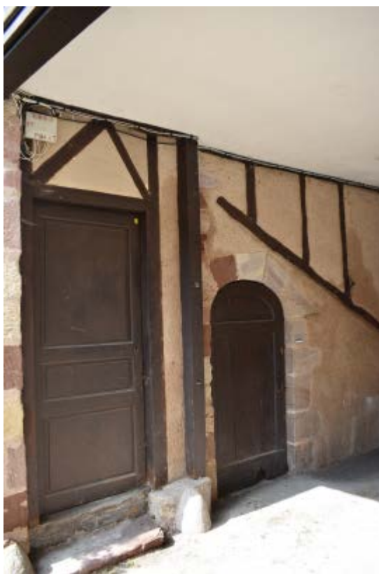
Figure 27 : mur nord du deuxième porche, porte rectangulaire et porte à arc en anse-de-panier.
