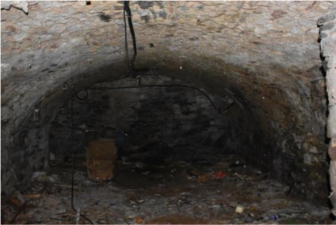
Figure 15 : bâtiment donnant sur la rue de l'Embergue, intérieur de la cave, vu depuis le nord.
