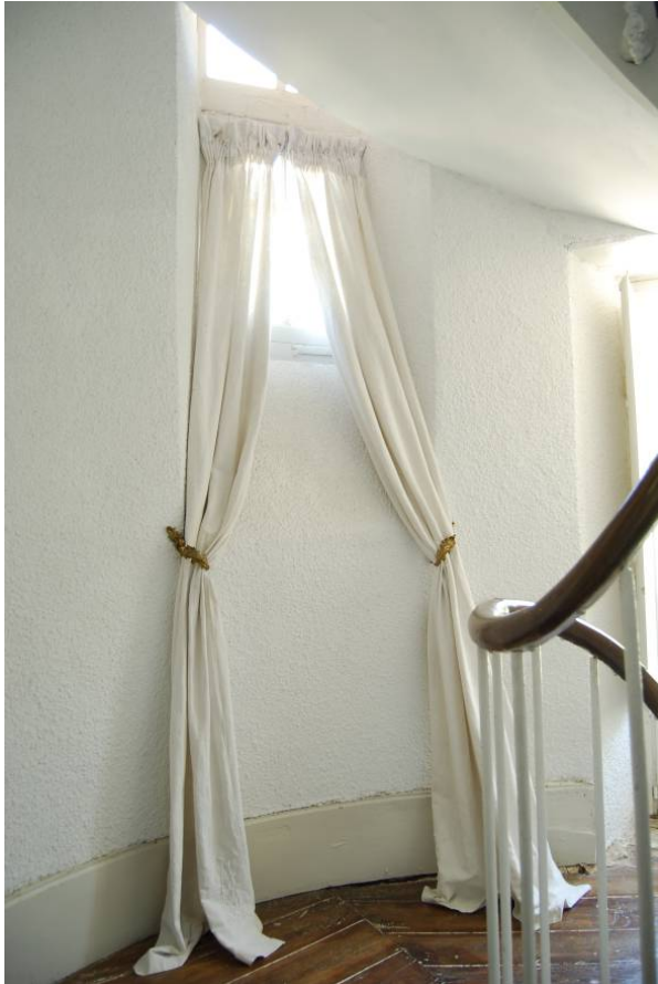
Fig. 33. La tour d'escalier, limon de l'escalier en charpente métallique passant au milieu de la fenêtre à demi-croisée.
