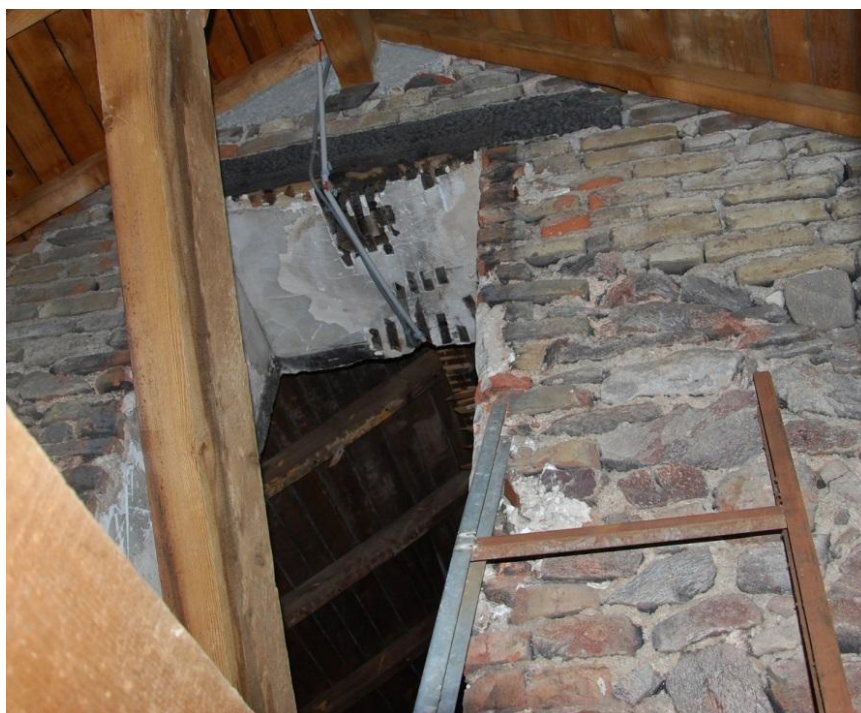
Fig.28 : Vue des éléments de charpente et de maçonnerie calcinés hérités de l'incendie de 1977.
