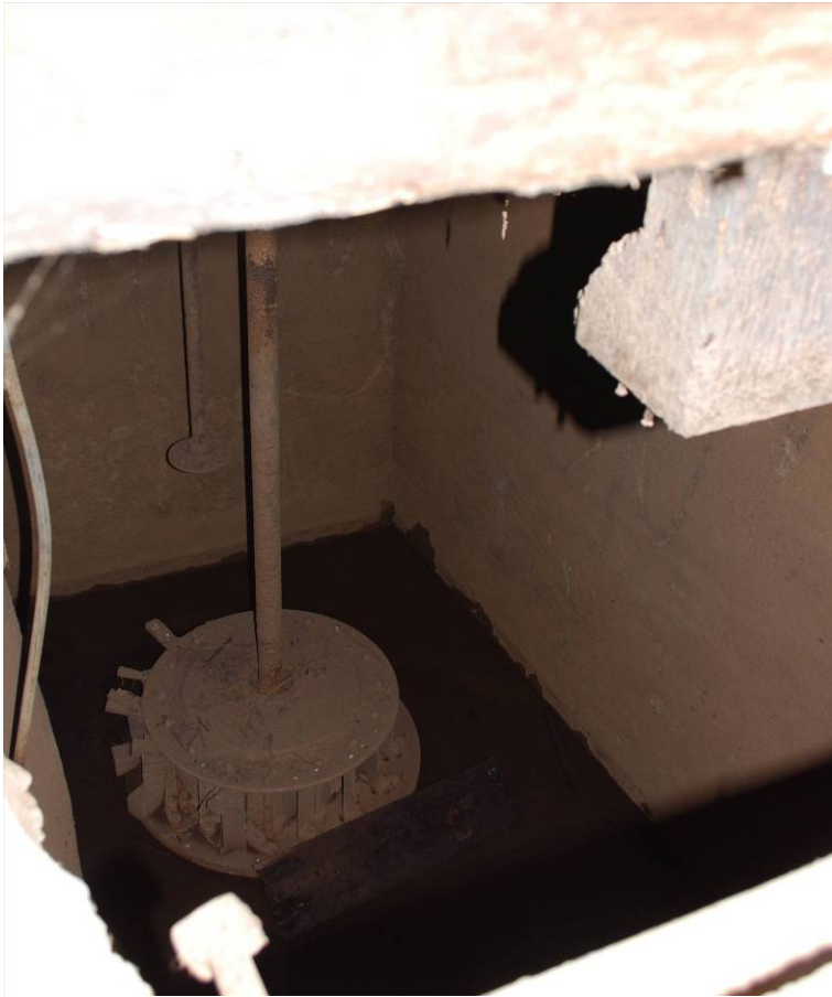
Figure 15 : Une des deux turbines dans sa cuve maçonnée.
